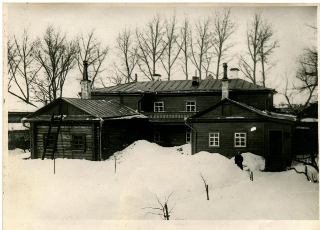
Фото 4. Вид дома со стороны двора. Отсутствие должной очистки снега вокруг дома ведет к подтаиванию и увлажнению древесины
